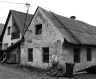
Dům čp. 180 čeká nová střecha.
