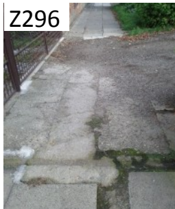
Bariérový úsek chodníku ve Školní ulici /nerovnosti/.
