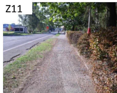
Bariérový úsek cesty v ulici Víta Nejedlého /nezpevněný povrch, nerovnosti/.
